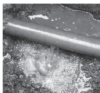
配水管の漏水
