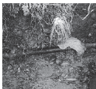
給水管の漏水
