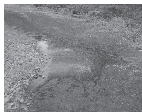
道路からの漏水
