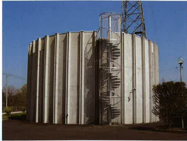
西部台配水場 (PC 1,000m 3 ) ※県水受水 (1,000m 3 /日)
