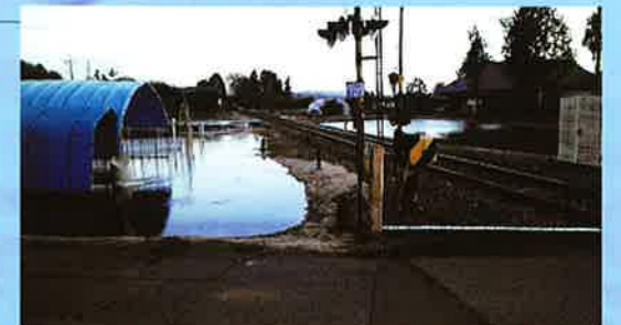
大和田地内配水管漏水
