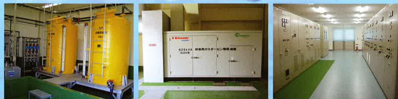
次亜塩素酸ソーダ注入設備
