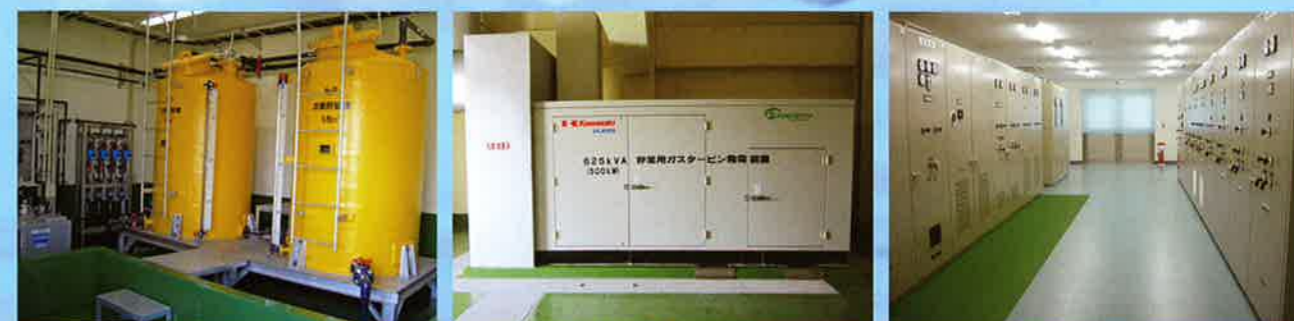
次亜塩素酸ソーダ注入設備
